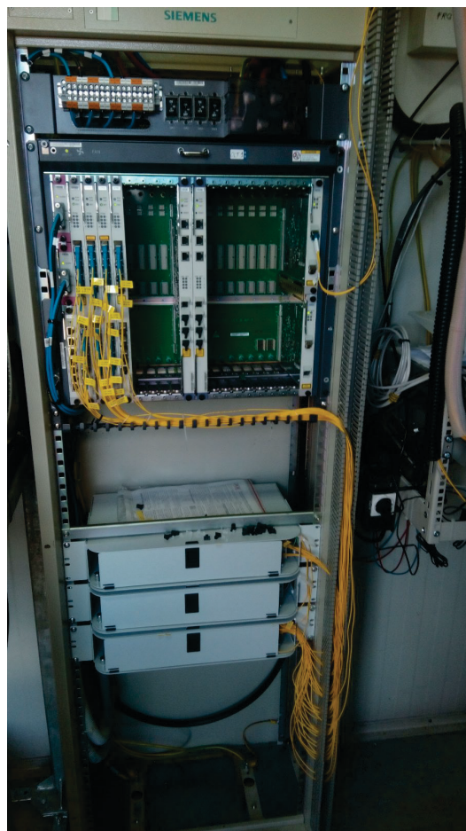
Фиг. 2. Външен вид на сървърно помещение с OLT Huawei MA5600T
